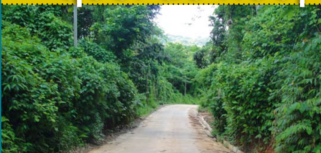
Travaux de création d'une liaison RN1 / RD3 au quartier La Haut (Ranch)
